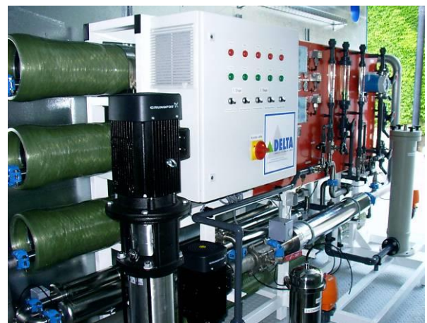
Umkehrosmoseanlage zur Behandlung von Sickerwasser
